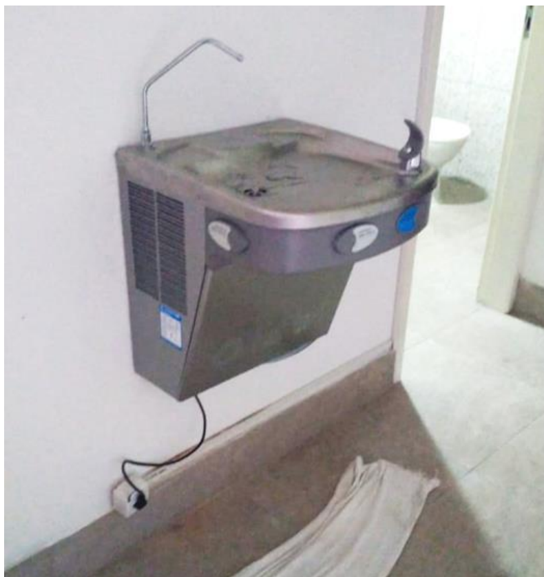
Figura 1: Purificador de Água instalado na Sede do Instituto HAHAAH
